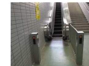
豊橋駅西口自転車等駐車場（駅前地下エリア）のエスカレータ
