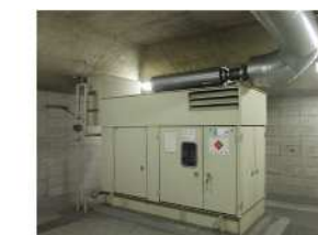
豊橋駅東口自転車等駐車場（駅前地下エリア）非常用発電設備
