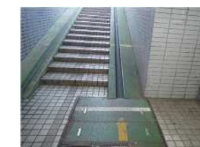
豊橋駅西口自転車等駐車場（駅前地下エリア）の自転車搬送設備
