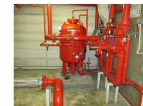
豊橋駅西口自転車等駐車場（駅前地下エリア）の泡消火設備
